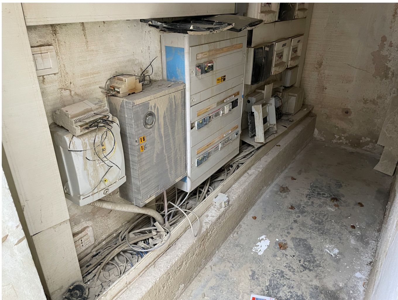
Il locale contatori, con i cavi completamente sommersi dal fango secco
